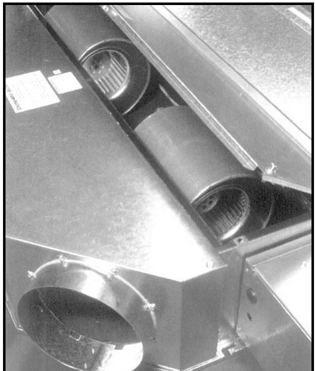
Frame 4 : Fan access panel
